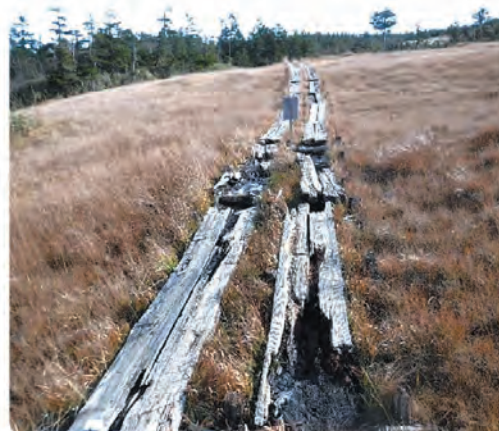
傷んでいる木道
