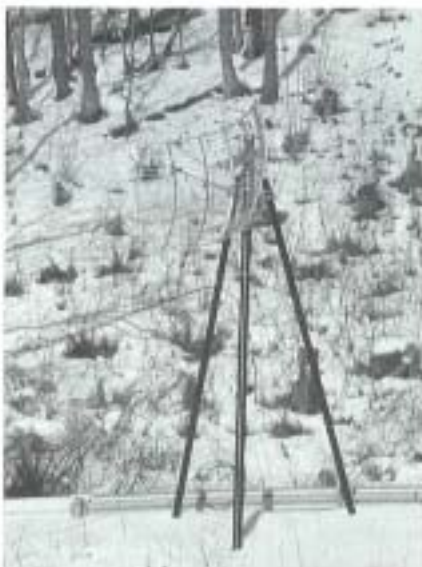
戸倉に設置された地デジ受信アンテナ
